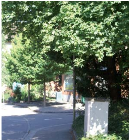
Eine Leuchte, die nicht leuchten kann. Bild: pl
